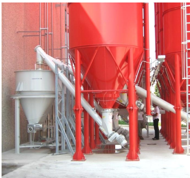
Rörtransportörer med skjutande drift, monterade under siloutlopp.
