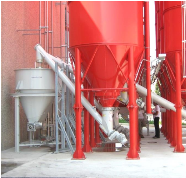
Rörtransportörer med skjutande drift, monterade under siloutlopp.
