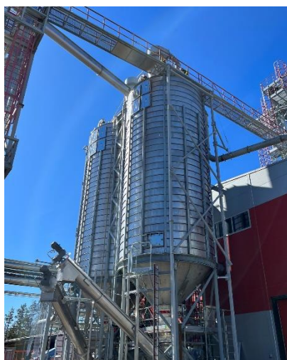
Rostfria silos, 2st, 240m 3 inkl sprängbläck skruvar etc.
